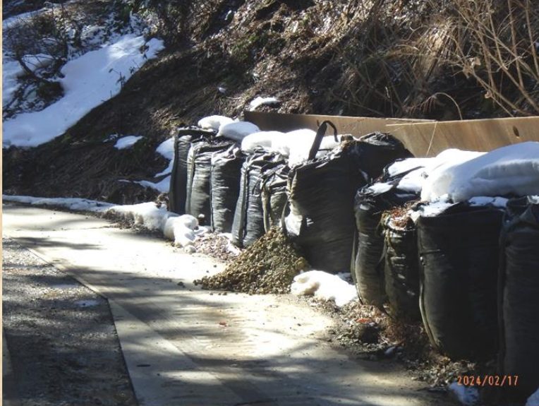
■フレコンが劣化して碎石がはみ出てきた
