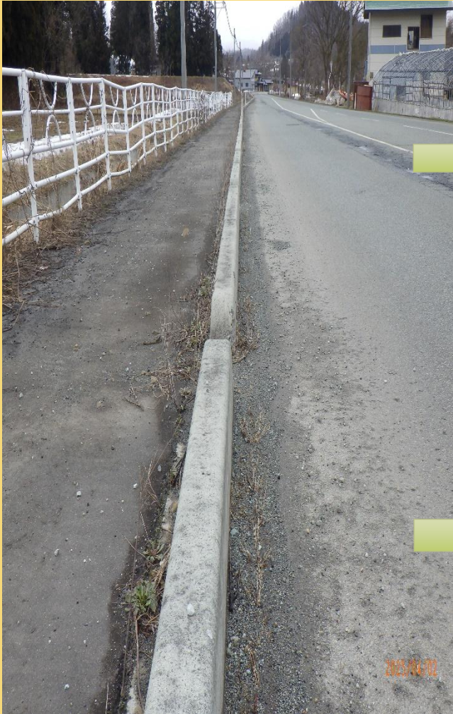
■ 清掃前 (道路脇に砂利が溜まる)
